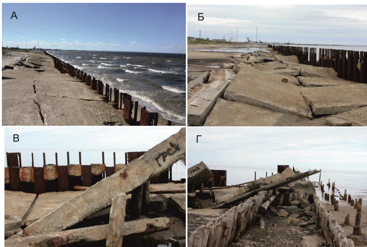
Рисунок 81. Абразионный участок морской береговой зоны о. Ягры. Разрушение берегозащитных сооружений в юго-западной части о. Ягры. А – 2011; Б, В – 2014. Станция 14-Я-1
