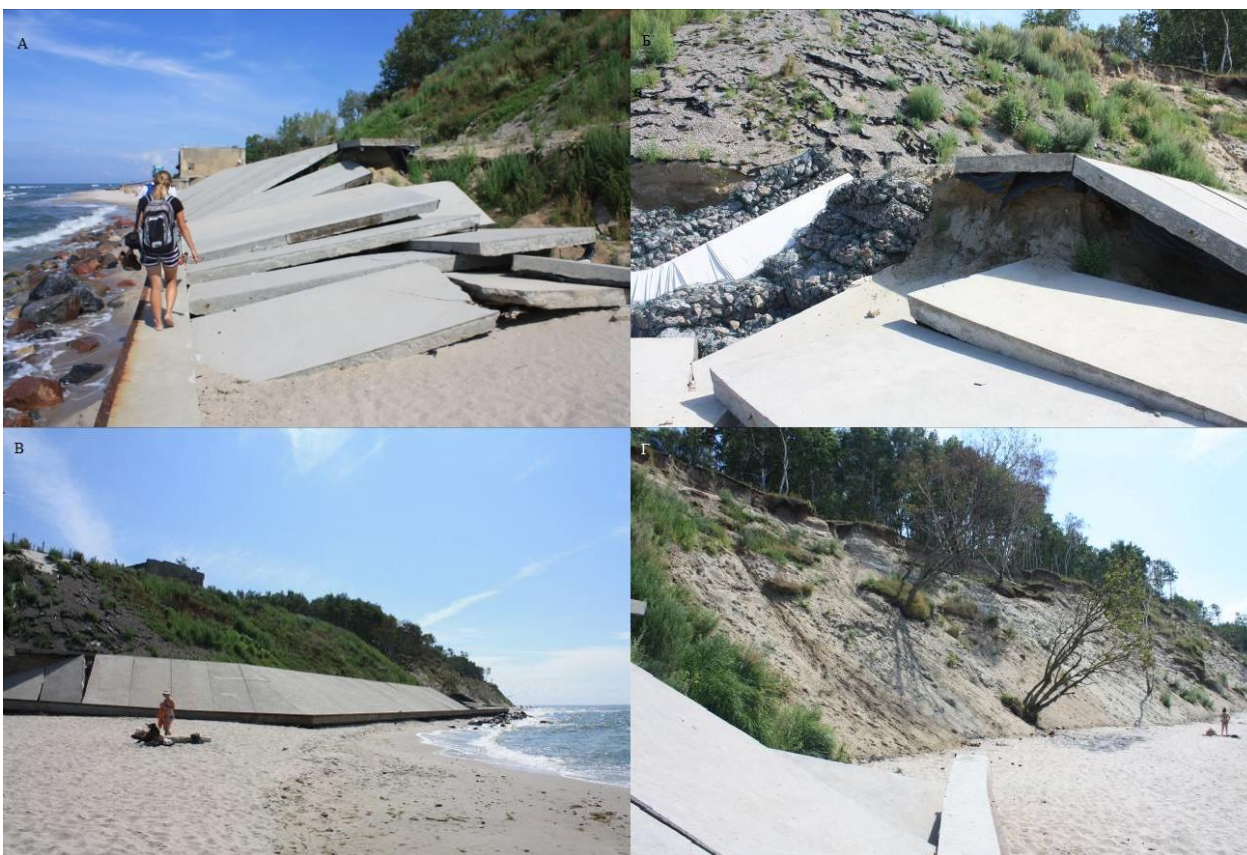
Рисунок 163. Частичное разрушение откосной подпорной стенки очистных сооружений пос. Янтарный. Между станциями наблюдения 14-ЗСБ-3 и 14-ЗСБ-4
