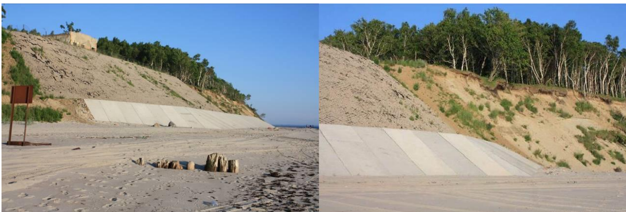
Рисунок 162. Откосное укрепление очистных сооружений пос. Янтарный (июнь 2013 г.)
