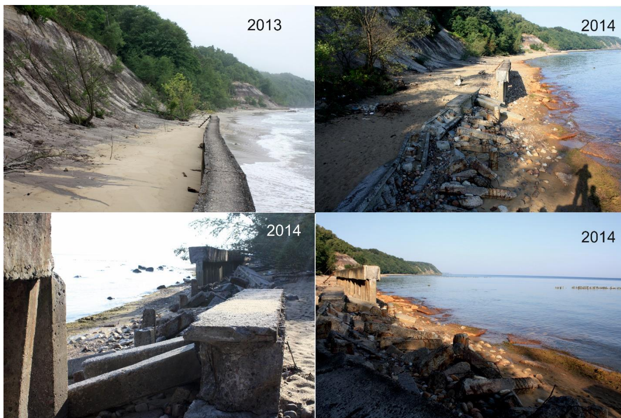
Рисунок 152. Разрушенная штормами 2013–2014 гг. бетонная опояска. Станция наблюдения 14-ССБ-8
