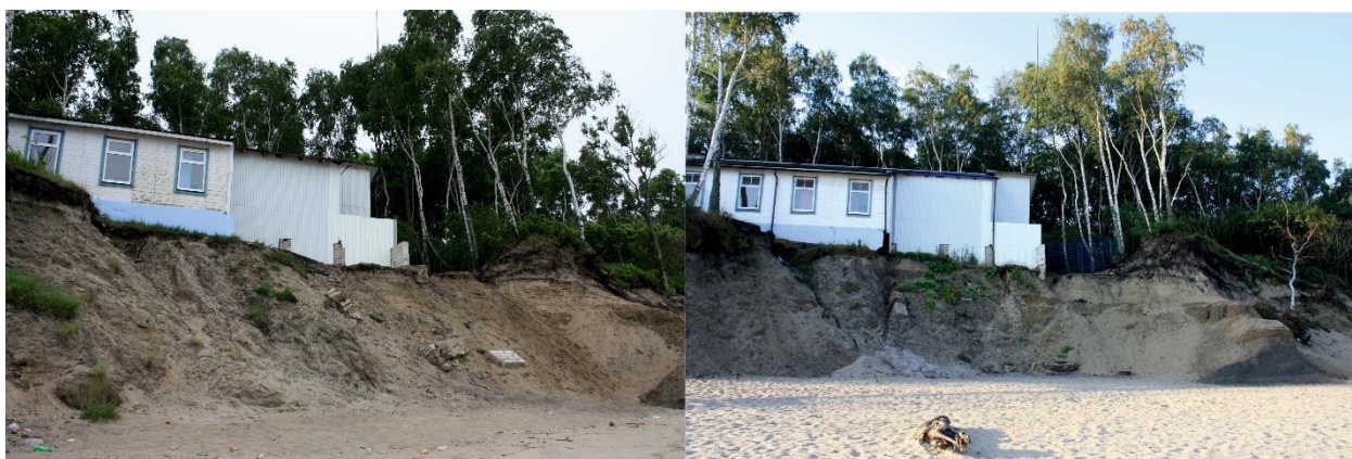
Рисунок 151. Продолжение разрушения жилой инфраструктуры детского оздоровительного лагеря. Станция наблюдения 14-ССБ-4
