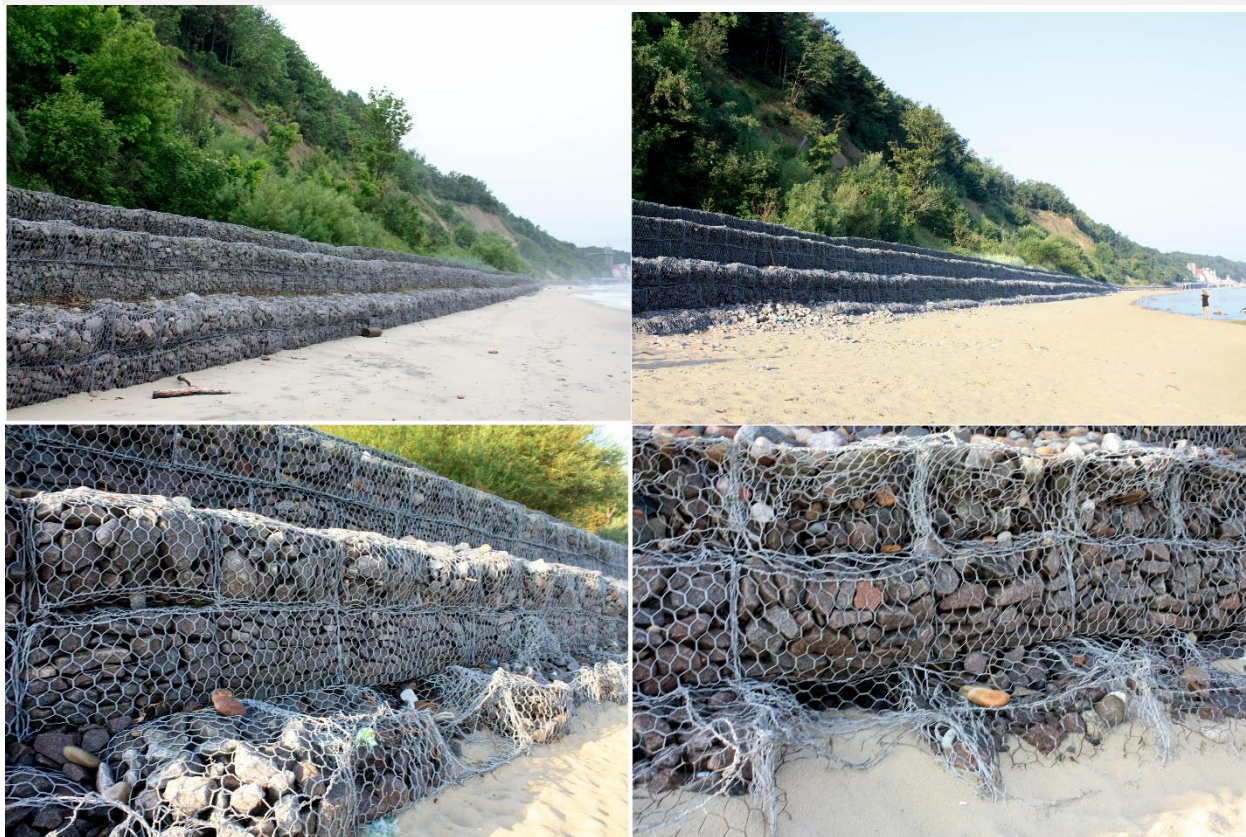
Рисунок 154. Ухудшение состояния склонов и разрушение габионов к востоку от Светлогорского променада. Станция наблюдения 14-ССБ-7
