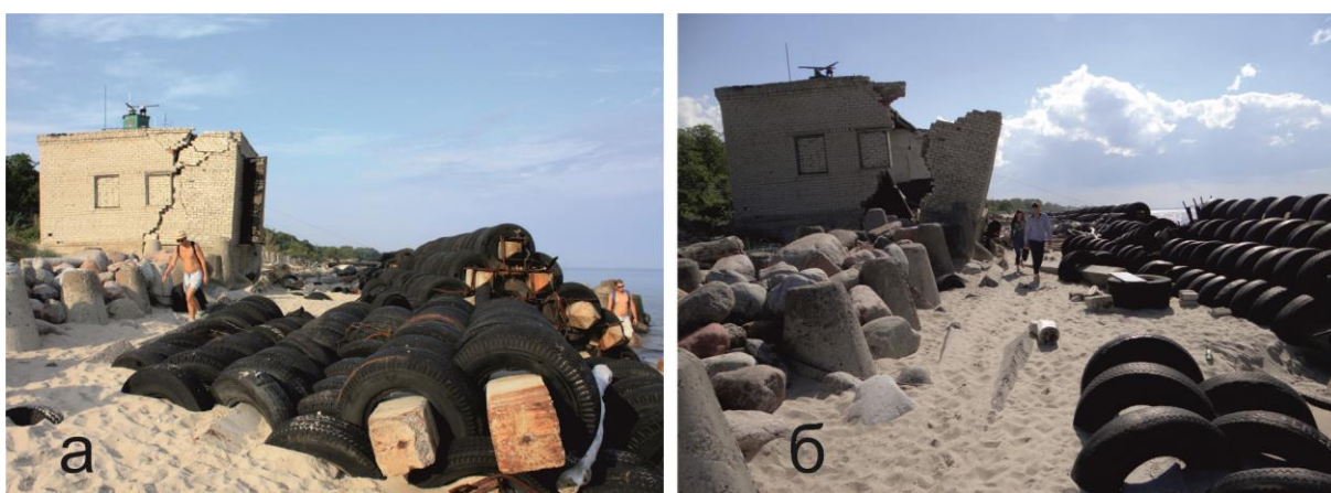
Рисунок 140. Развитие абразионных процессов с вымыванием песка с пляжа и разрушением строения и берегозащитных укреплений вблизи пограничного ПТН: а – 2014 г., б – 2015 г.
