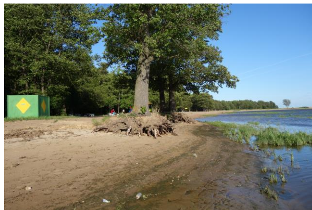
Рисунок 89. Разрушение береговой террасы в западной части пляжа пос. Морские Дубки, высачивание железистых грунтовых вод, снимок 11 июня 2015 г., т. н. 15-НГБ-7. Фото Н.Б. Малышевой
