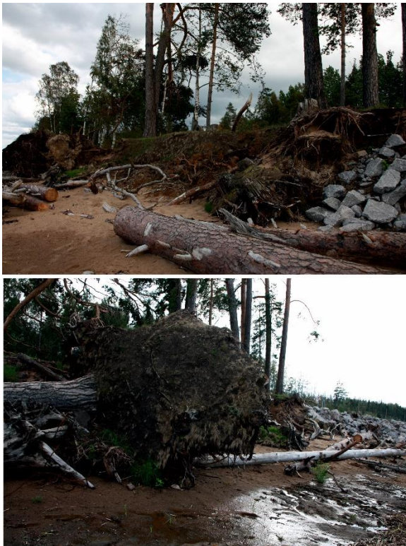
Рис. 69. Активизация абразионно-оползневых процессов вблизи аварийного участка шоссе Санкт-Петербург – Ручьи
