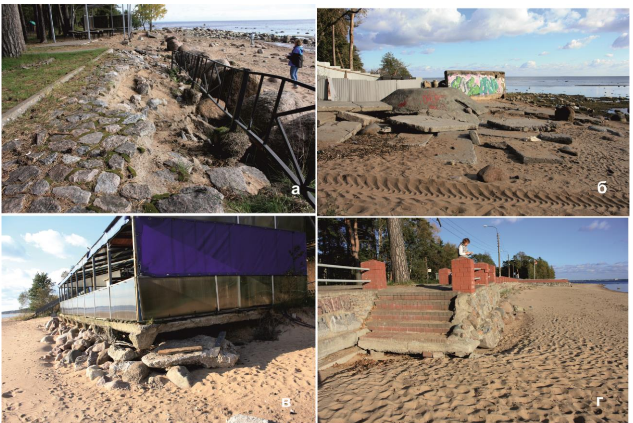
Рис. 43. Разрушение береговой инфраструктуры после декабрьских штормов: а – разрушенный променад в пос. Смолячково; б – размыв берегозащитных сооружений на участке канализационных коллекторов в г. Зеленогорск; в – разрушенное основание ресторана в пос. Комарово; г – подмыв основания лестницы променада в пос. Репино
