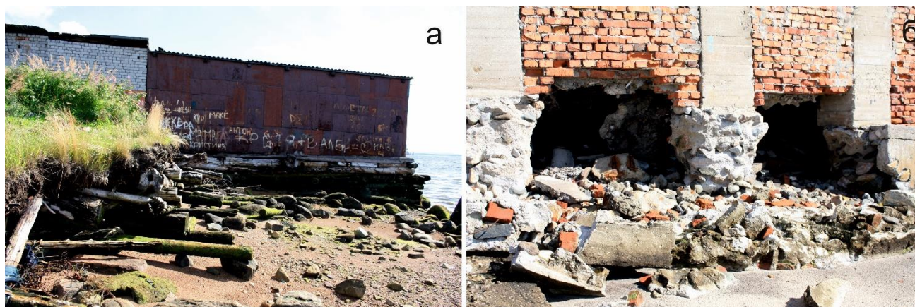
Рис. 26. Основания сооружений, разрушенные в результате воздействия абразии
