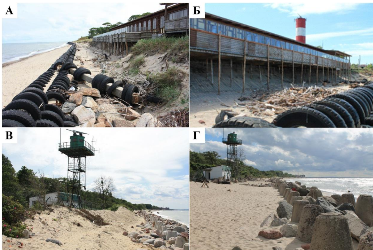
Рисунок 109. Разрушение берегозащитных сооружений абразией: А, Б – т. н. 17-ККБ-3 и 18-ККБ-3; В, Г – здание КПП, т. н. 17-ККБ-12 и 18-ККБ-12
