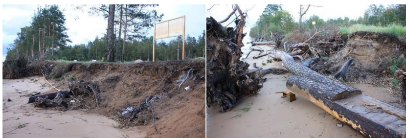
Рисунок 46. Активизация абразионных и осыпных процессов после осенних штормов 2018 г. вблизи аварийного участка шоссе Санкт-Петербург–Ручьи
