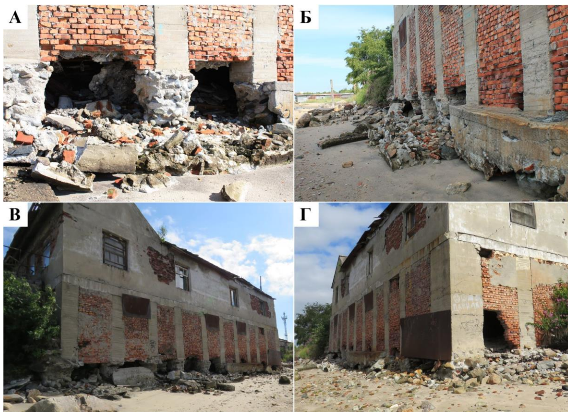
Рисунок 22. Основания сооружения, разрушенного в результате воздействия абразии: А – фото 2016 года, Б – фото 2017 года, В, Г – фото 2018 года
